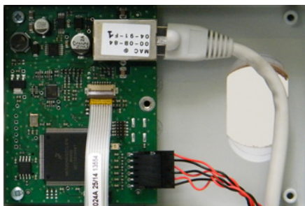
Conexión a la tarjeta electrónica de la caja de control
